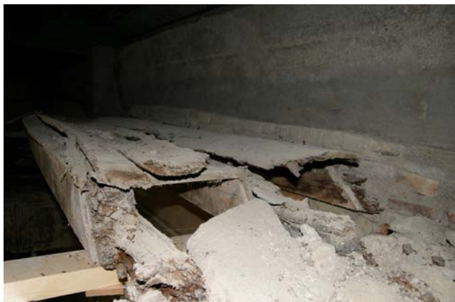
Figura 33. Degradación de la madera en la calle XI. Fotografía: Artyco, Archivo General IPCE.
