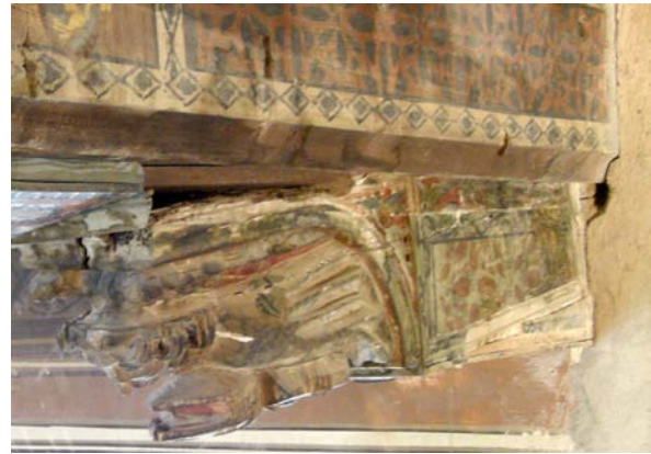
Figura 6. En la zona superior se observa el tablero añadido a los lados de las jácenas, y el movimiento de los canes. Fotografía: Artyco, Archivo General IPCE.
