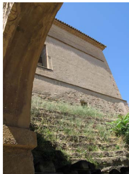
Figura 20. Contrafuerte escalonado en la base del muro oriental del salón del alfarje. Fotografía: Ana Carrassón.
