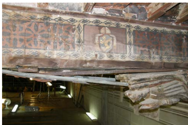
Figura 27. Viga IV con el tablero de refuerzo y pletinas de hierro. Fotografía: Artyco, Archivo General IPCE.
