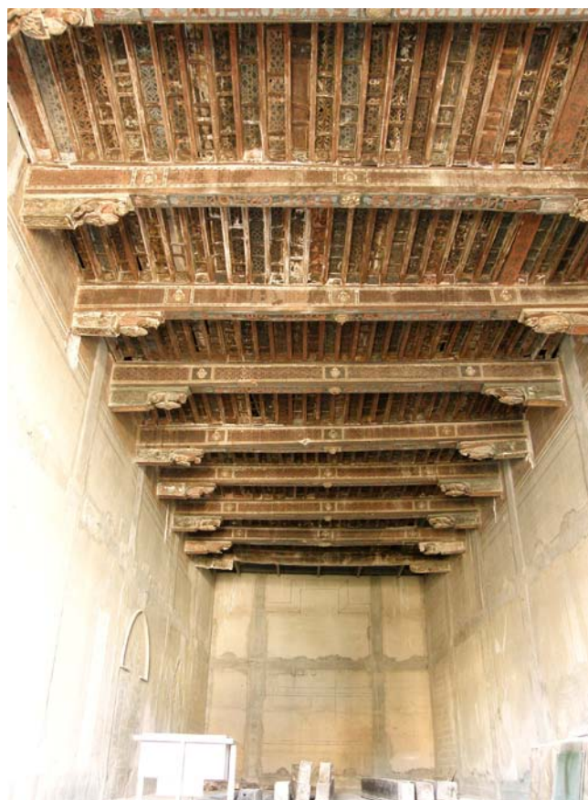
Figura 2. Vista general, norte sur, de la sala. El muro divisorio de la sala, construido por el obispo Bardaxí, estuvo a nivel de la última viga hasta el siglo pasado. En los paramentos se ven las consolidaciones de hormigón de finales del siglo xx. Fotografía: Artyco, Archivo General IPCE.
