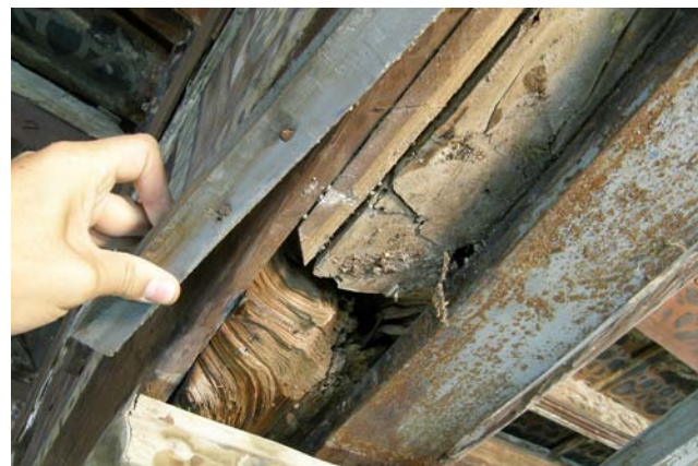
Figura 24. Jácena IV rotura y refuerzos metálicos. Fotografía: Artyco, Archivo General IPCE.
