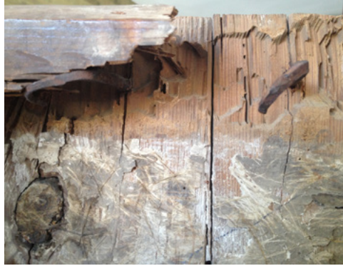
Figura 39. Barrote carcomido, quedando a la vista el clavo de forja. Fotografía: Cristina Salas.
