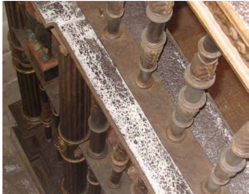
Figura 20. Pérdida del entonado de las planchas de polietileno. Fotografía: Paz Ruiz.
