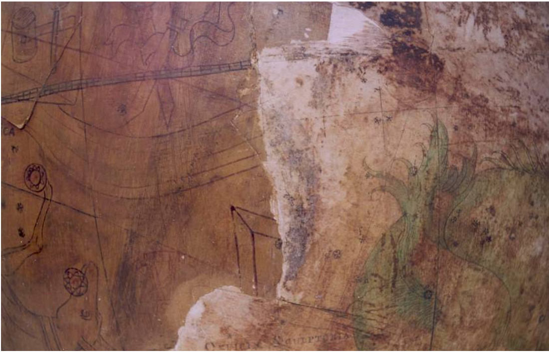
Figura 23. La acción de un fluido ha alterado la capa de protección y ha degradado el color del fondo, teniendo un color blanquecino.
