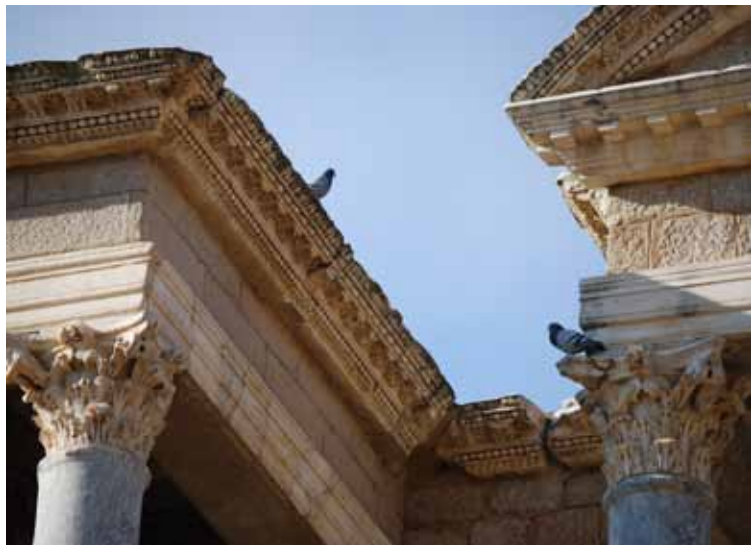
Figura 22. Biodeterioro por incidencia de palomas en la escena del teatro. Fotografía: AOR – IPCE, 2011.
