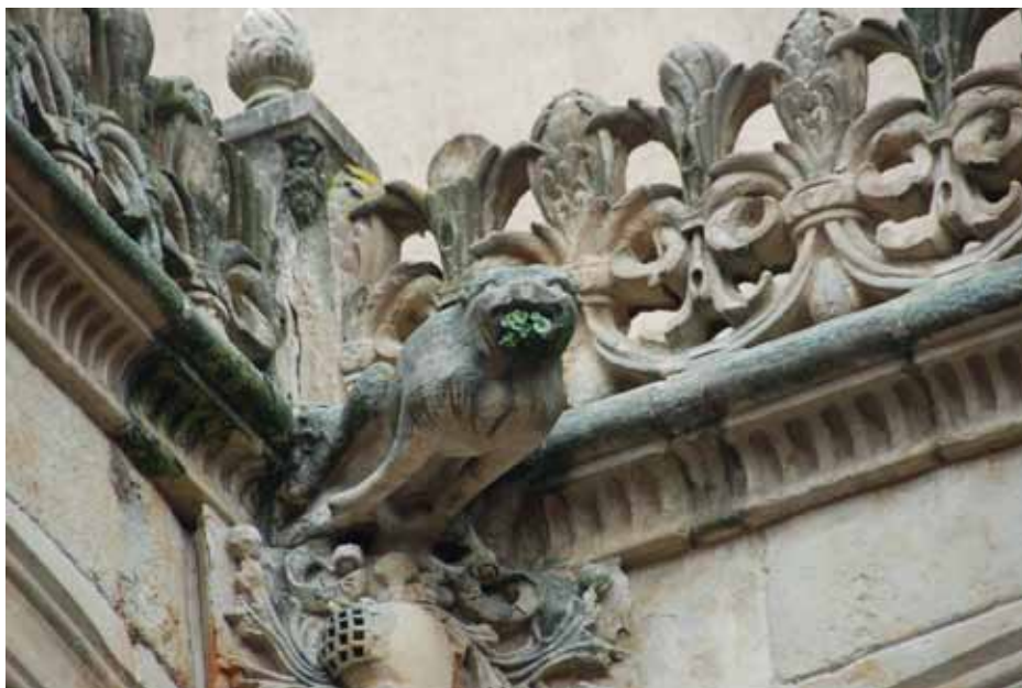
Figura 20. Evaluación de riesgos relacionados con falta de mantenimiento. Gárgola de Salamanca. Fotografía: Juan A. Herráez, 2011.
