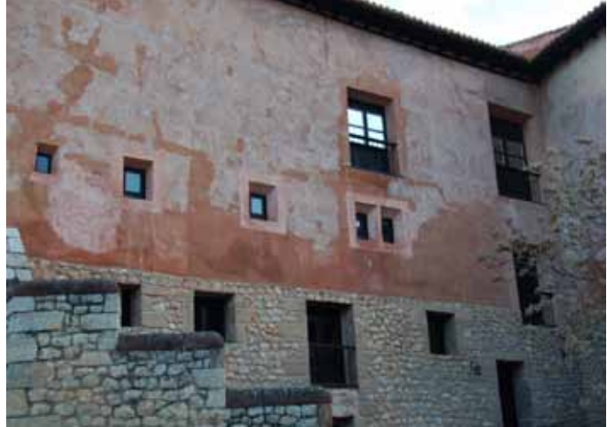
Figura 25. Estado de conservación de la fachada y aleros de la cubierta del museo. Fotografía: Juan A. Herráez, 2010.
