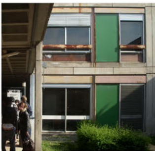
Galerías - patios interiores. Degradación materiales fachada, 2012.
