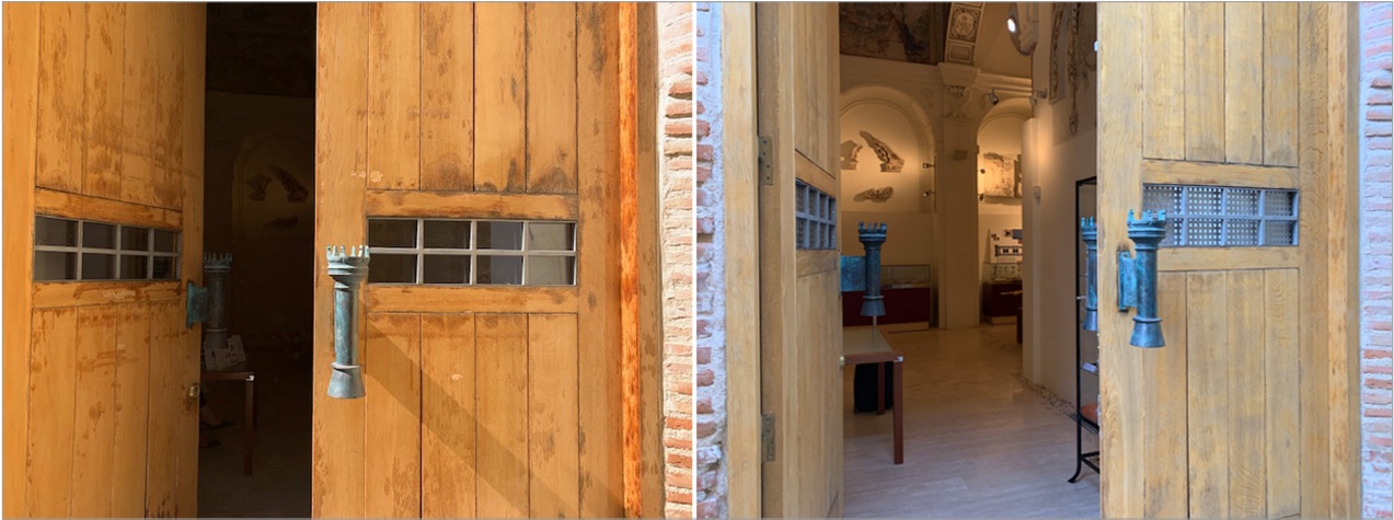
Figura 6. Detalle del vidrio de la puerta (izquierda) y su sustitución por una rejilla (derecha) con el fin de favorecer la ventilación pasiva del edificio. Fotografía: Alba García Bernabé.
