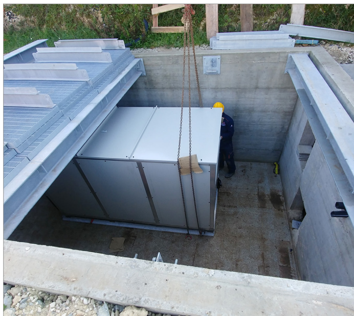
Figura 13. Dispositivo de climatización en compartimento subterráneo. Fotografía: Mario Cotrino.
