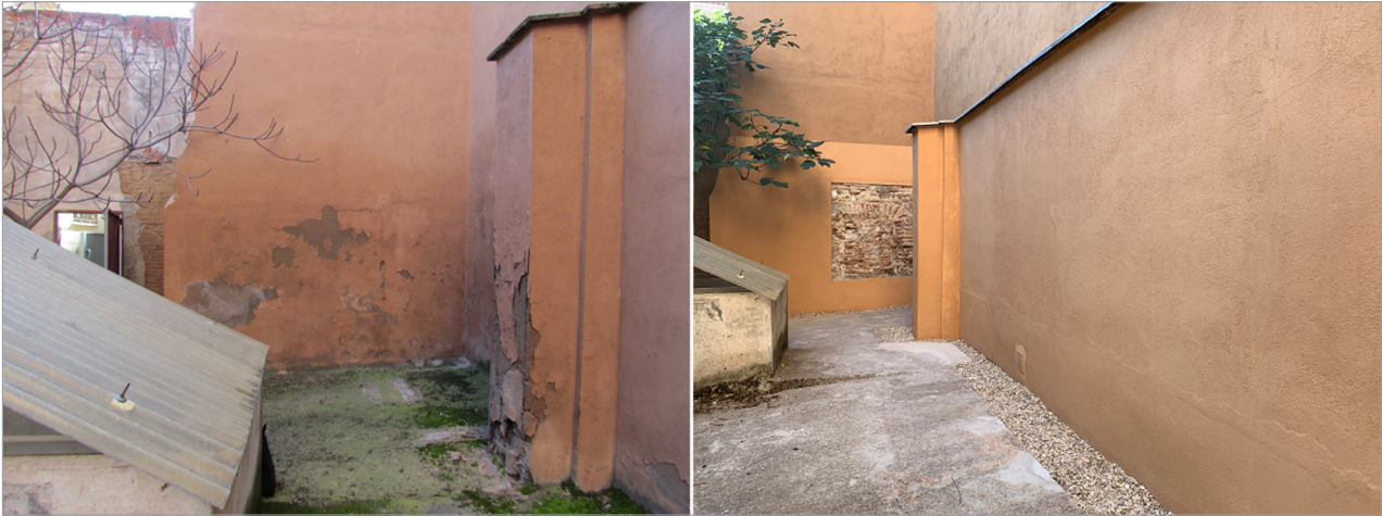
Figura 3. Vista general del patio trasero antes (izquierda) y después (derecha) de la intervención. Se aprecia la afección por humedad que presentaba inicialmente y la posterior construcción del drenaje perimetral. Con motivo de la intervención se encontraron elementos constructivos de conexión con la antigua iglesia, dejándose a la vista mediante una ventana arqueológica. Fotografía: Alba García Bernabé.
