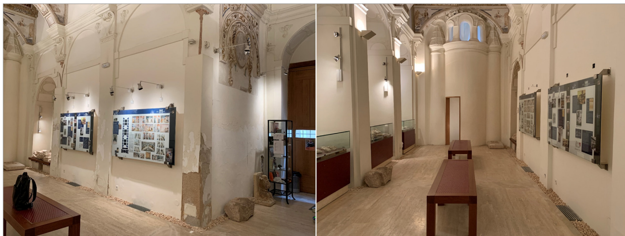
Figura 5. Interior de la capilla de Luis de Lucena. Se aprecian los daños por humedad que presentaba antes de la intervención (izquierda). Se han empleado revestimientos de mortero de cal natural para favorecer la transpiración de los propios materiales históricos. Fotografía: Alba García Bernabé.
